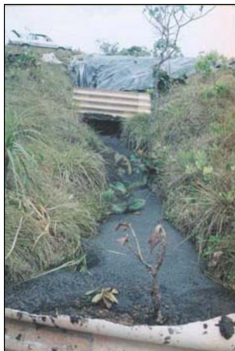
FIGURA 6 – Nascente do Vereda Grande represado a fim de conter o lodo do esgoto.
