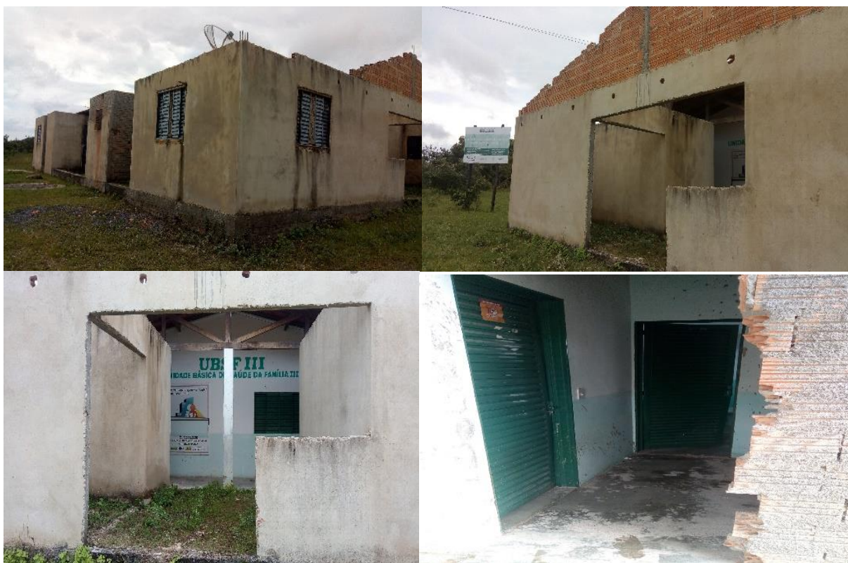
Figura 5: Imagens da situação atual do posto de saúde em janeiro de 2018
